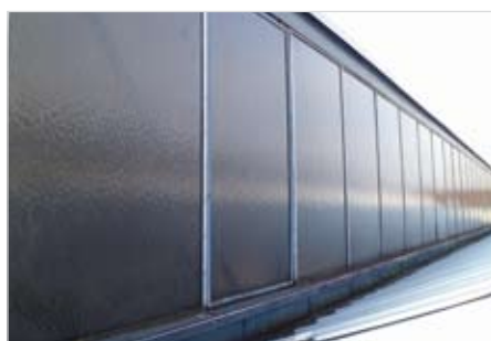
Wenig Licht und schlechter Isolierwert - alte Sheddachverglasungen verschwenden Energie.
